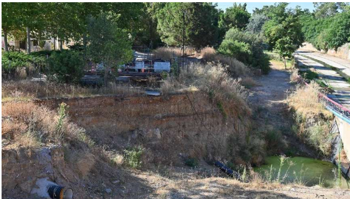
Estación de bombeo del Rivillas. / Andrés Rodríguez
