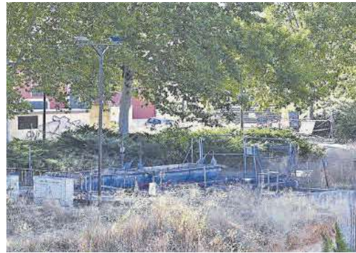
Estación de bombeo del Rivillas.
